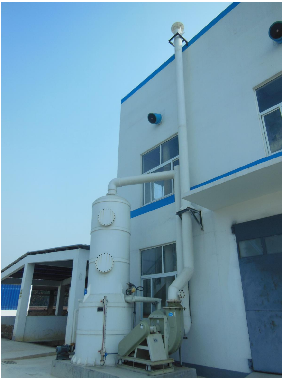
图 4-6 3#废气处理装置及排气筒
