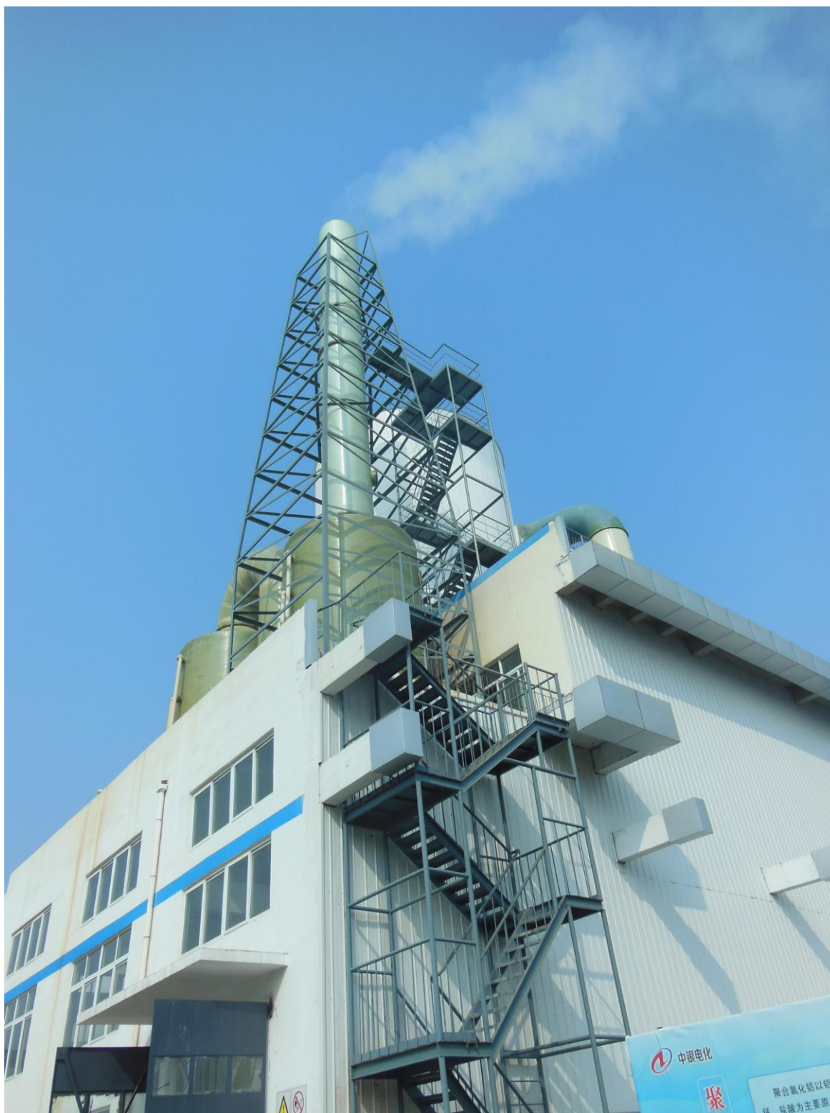
图 4-3 2#废气处理装置及排气筒
