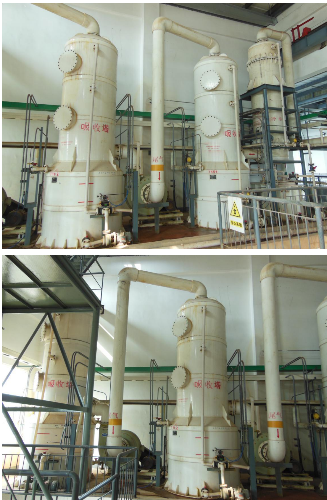
图 4-2 1#废气处理装置及排气筒
